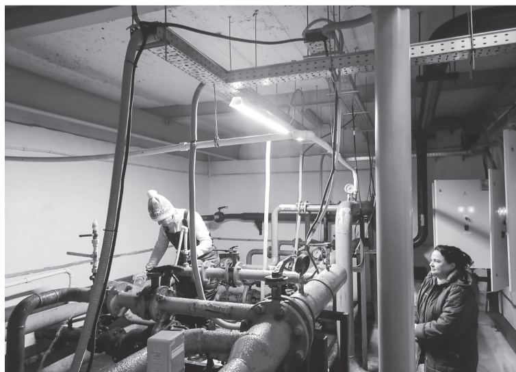
Пробы в насосной станции очистных сооружений
